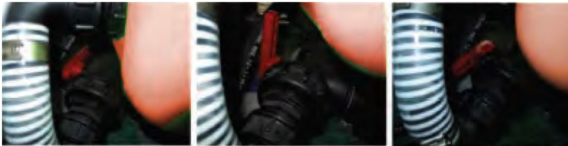
Salida del depósito químico abierta
